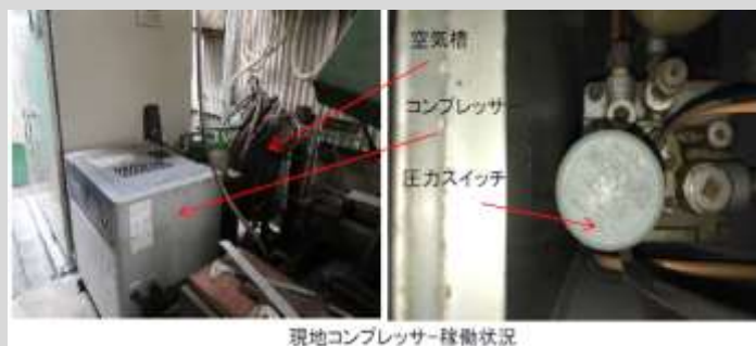
現地コンプレッサ稼働状況
