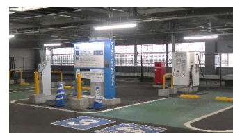
充電設備の整備
