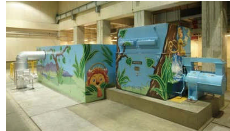
■蒸気タービン発電機 ボイラーで発生した蒸気を利用して、蒸気タービンを回し、最大12,600kWの電力を発生させます。
