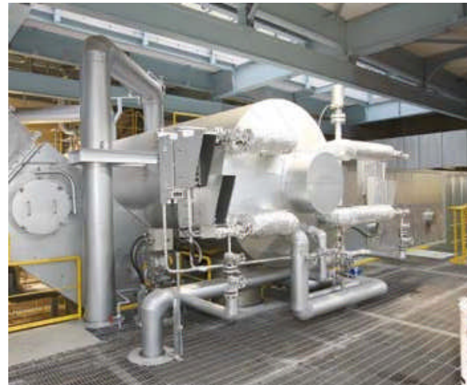
■ボイラー 焼却炉より送られてきた排ガスを利用して高温高圧の蒸気をつくります。また、排ガスを210℃以下まで冷却します。
