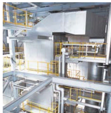
■触媒脱硝塔 排ガス中に残った窒素化合物やダイオキシン類を分解し、クリーンなガスを煙突から大気中に排出します。
