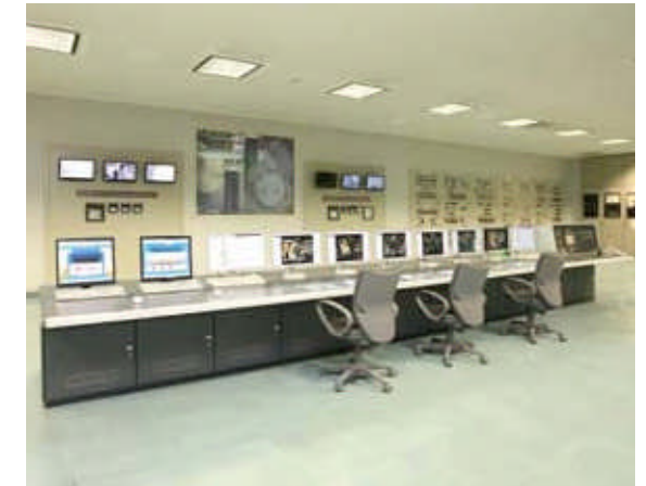
■中央制御室 プラント設備全体の運転状況を集中監視および制御をしています。各設備はコンピュータシステムにより自動運転されています。
