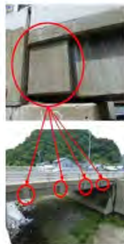
覆水切りが桁下まで打ち下ろさないため、横桁位置が確認する。
