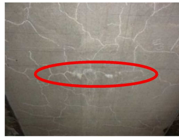
貫通ひびわれあり
