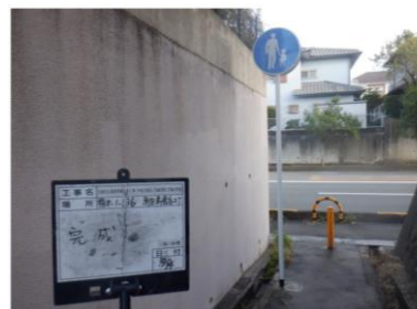
標識破損【対応後】
