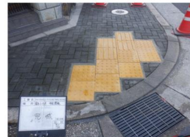
点字ブロック破損【対応後】
