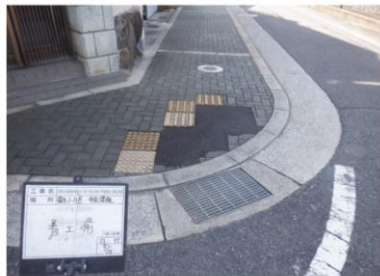
点字ブロック破損【対応前】
