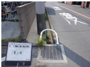
バリカー破損【対応前】
