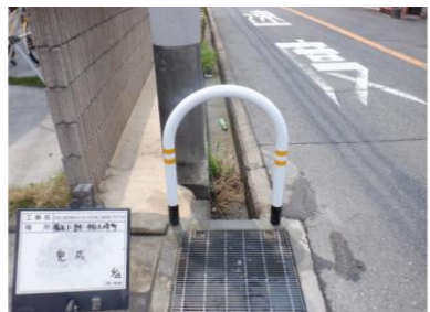
バリカー破損【対応後】
