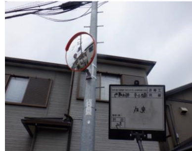
カーブミラー破損【対応後】
