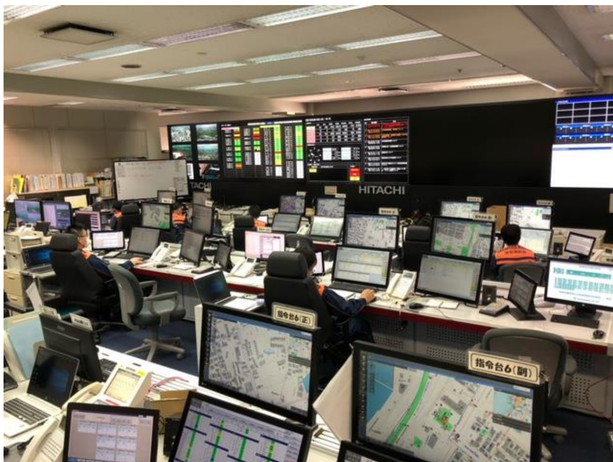
消防指令センターの様子
