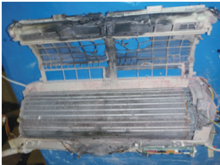
電装部品に付着した洗浄液が原因となり出火したエアコン
