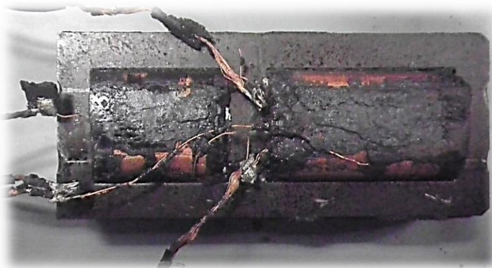
【出火後の照明器具内で焼損していた安定器】
