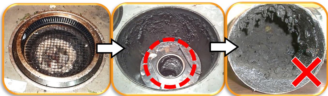
👉 実際に火災が起きた無煙ロースターとその排気ダクト内部の様子 👉
