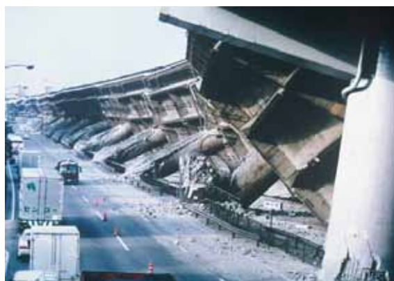
(阪神高速神戸線の被害)
