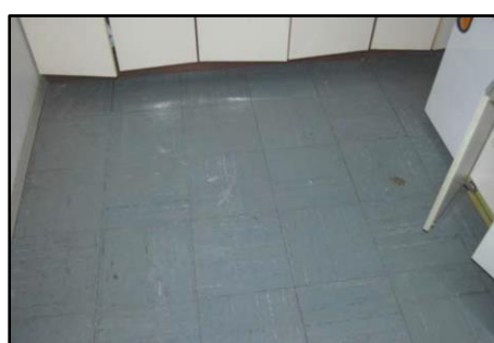
アスベスト含有 ビニル床タイル
