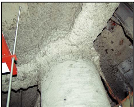
吹付けアスベスト
