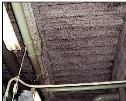
アスベスト含有 吹付けロックウール
