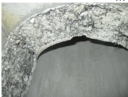
アスベスト含有断熱材 ※
