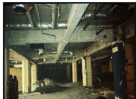
アスベスト含有耐火被覆材
