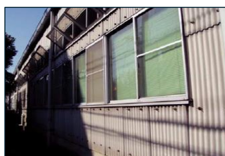
アスベスト含有 スレート波板
