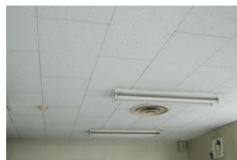
アスベスト含有 ロックウール吸音天井板
