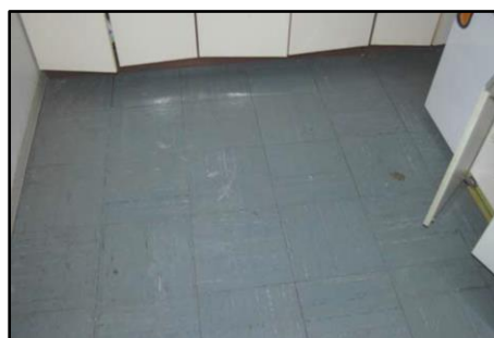
アスベスト含有 ビニル床タイル
