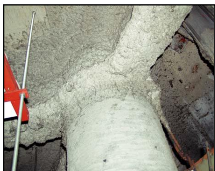
吹付けアスベスト
