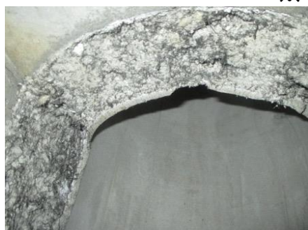
アスベスト含有断熱材 ※
