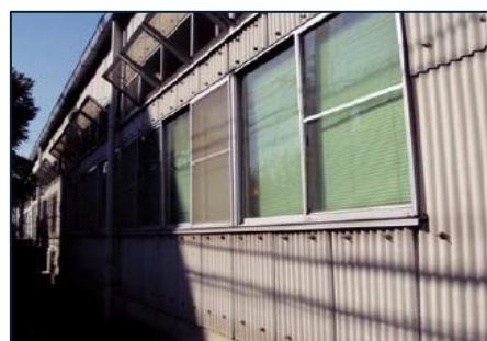
アスベスト含有 スレート波板
