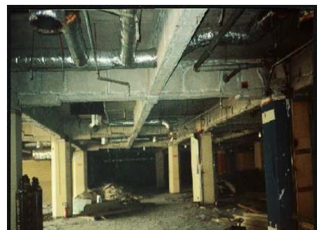
アスベスト含有耐火被覆材
