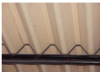
屋根用折板石綿断熱材
