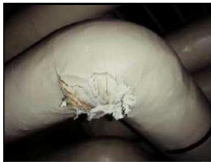
○配管保温材の露出
