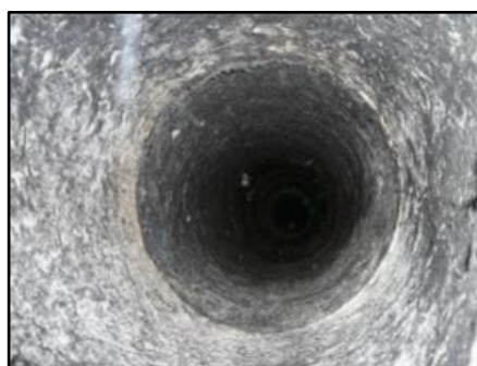
○煙突断熱材の軽微な劣化
