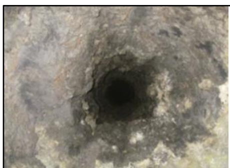
○煙突断熱材の著しい劣化
