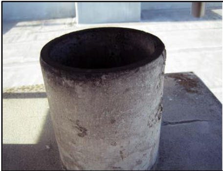
石綿断熱材（煙突内部）
