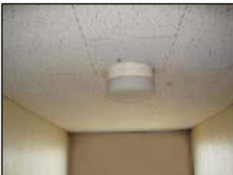
石綿含有石膏ボード（天井仕上材）
