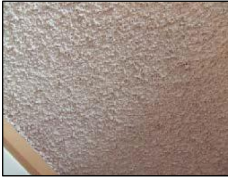
石綿含有吹付けパーライト（天井等の仕上材）
