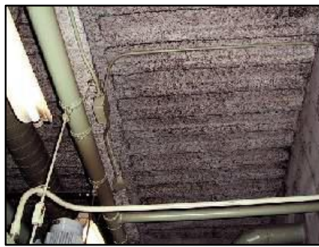
石綿含有吹付けロックウール (折板裏などの断熱材)
