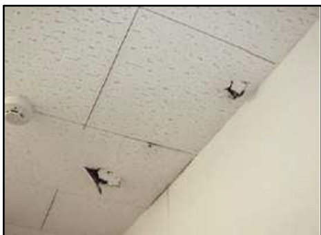
○天井ボードの破損
