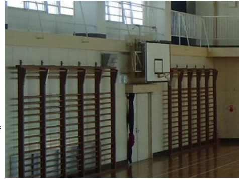
屋内運動場の肋木・ギャラリー・手すり 肋木を伝ってギャラリーに 上れない対策が必要
