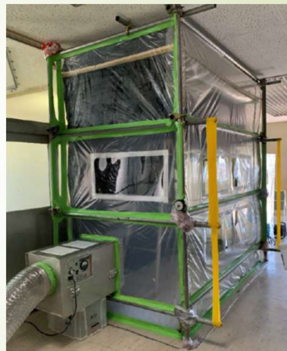
負圧除じん機側
