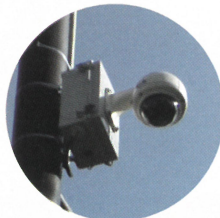
防犯カメラ設置
