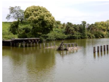
開発時に架けられた橋の残骸
