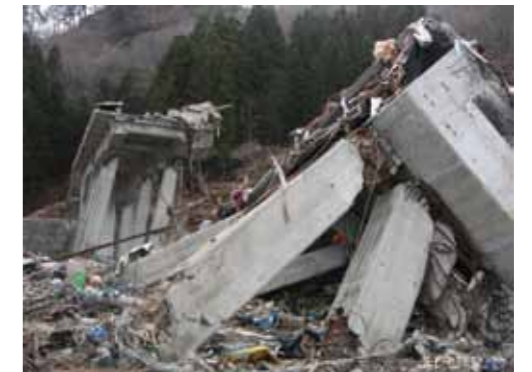
Ga Shimanokoshi bị đổ sập Cung cấp hình ảnh: Tài đoàn pháp nhân Trung tâm khoa học tổng hợp về phòng cháy chữa cháy
