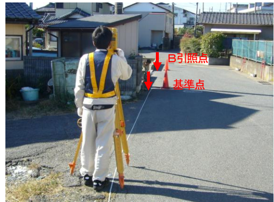
A引照点でのTSIによる視準(A引照点～基準点～B引照点)
