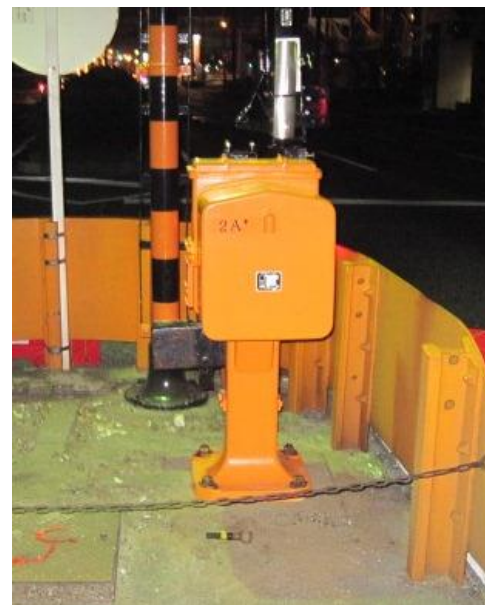
更新された踏切保安設備
