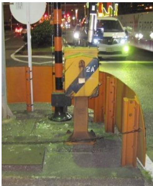
老朽化した踏切保安設備
