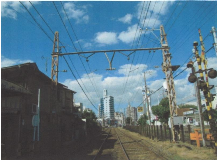
老朽化した電車線
