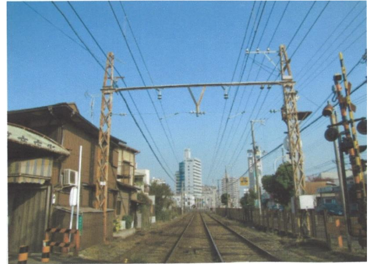
整備された電車線
