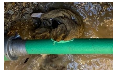
ガス管の破損状況
