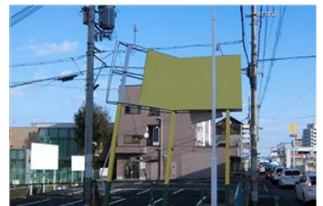
屋外広告物の板面の破壊
