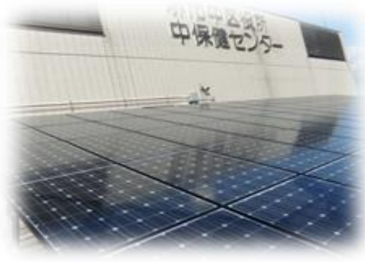
中区役所 太陽光発電パネル
