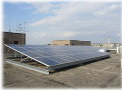
泉北下水処理場 太陽光発電パネル
