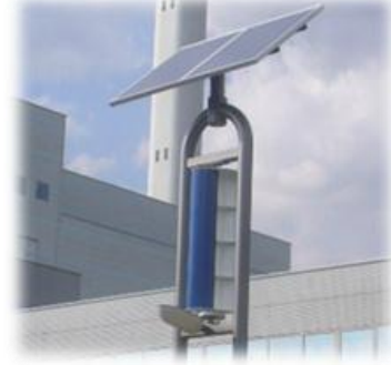
クリーンセンター東工場 ハイブリッド型 LED 外灯
