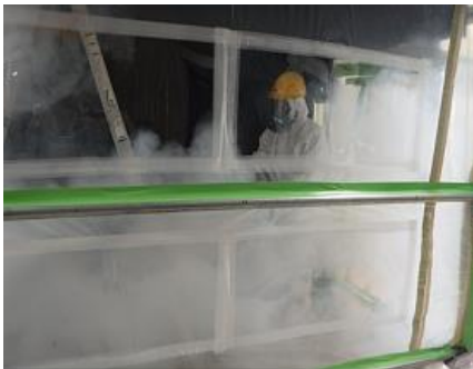
スモークマシンによる漏えい確認
