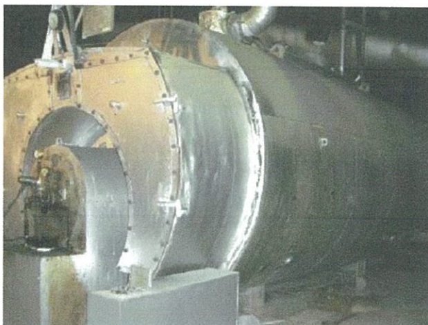
ボイラーの保温材
