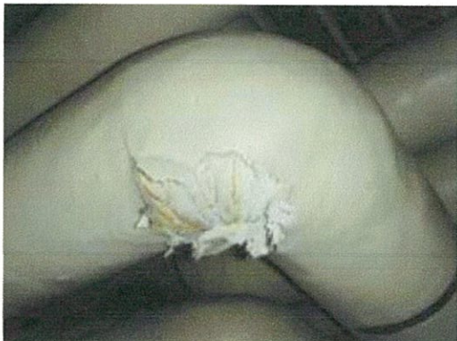
配管エルボの保温材
