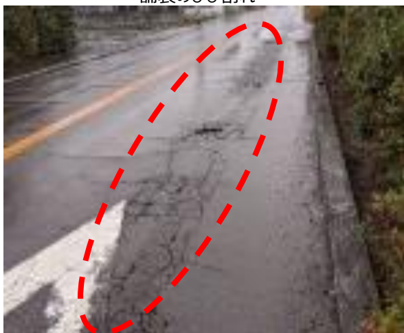
舗装のひび割れ
