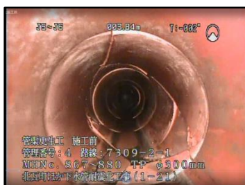
テレビカメラ調査による管きよの劣化状況
