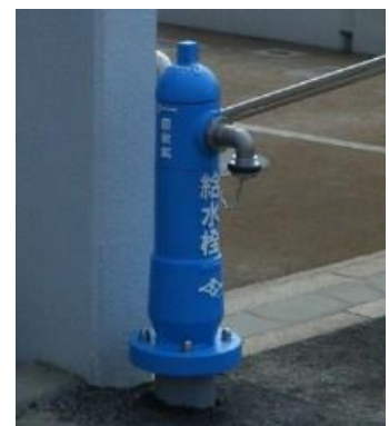
災害時給水栓写真(出典:仙台市)
