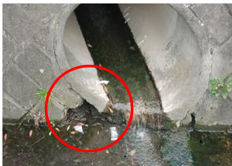
護岸損傷状況
