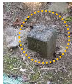
埋没している境界杭
