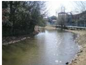
滞水により生じた浸食
