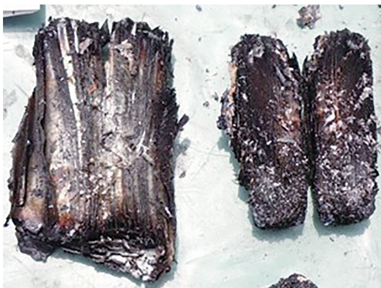
焼損した壁と火災原因となった低圧進相コンデンサの内部素子
