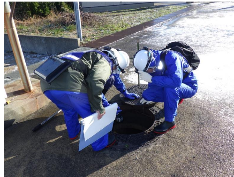
下水道被災調査①
