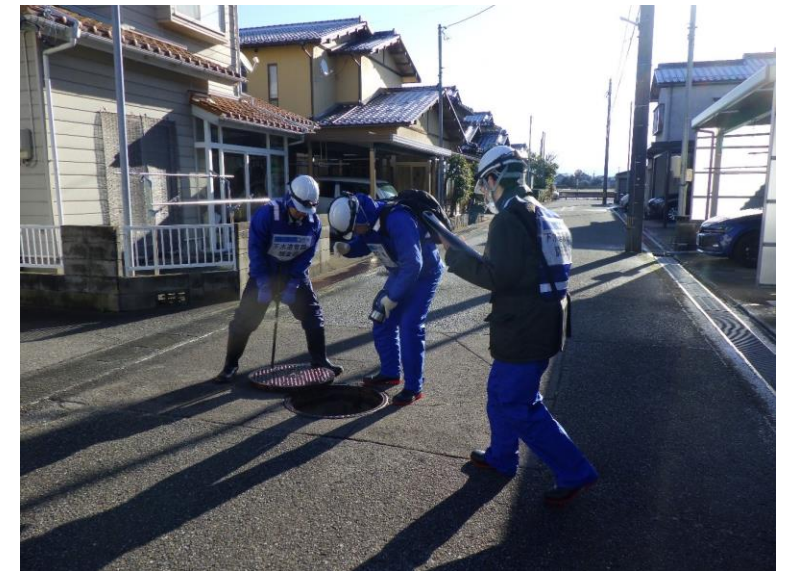
下水道被災調査②
