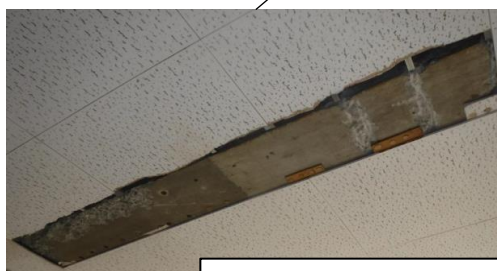
ボード剥がれ（補修済）
