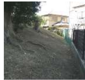
露出した樹根
